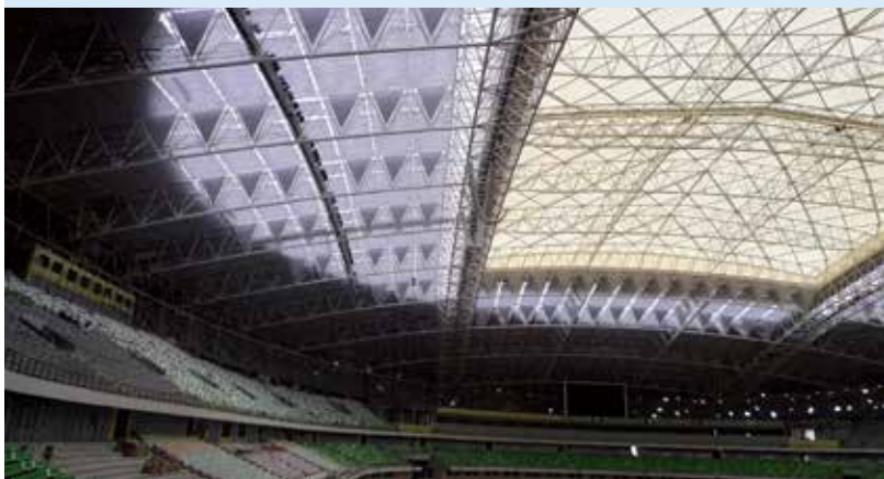
安装在中国最大的开合屋盖体育场的空间吸声体
